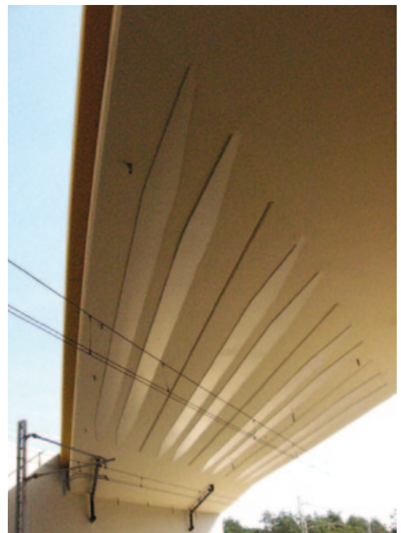
Abb. 7, Brücke WD-4 in der Untersicht mit externer Bewehrung, die dem Kraftfluss angepasst ist
