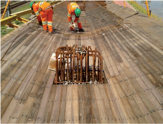
Bild 19 Herstellung Rampenbauwerk entlang Radweg vor dem Rio Pinheiros Construction of ramp structure along the bicycle lane in front of Rio Pinheiros
