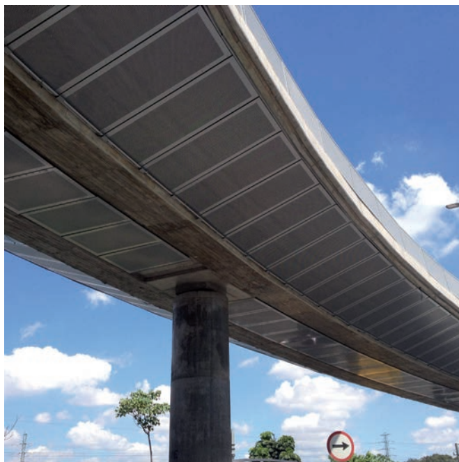
Bild 10 Überbau mit nahezu vollständiger Lochblechverkleidung; LED-Installation noch nicht vorhanden Superstructure with almost completed perforated plate sheeting; LED installation not yet arranged
