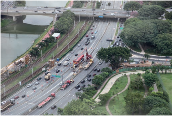
Bild 15 Blick vom Complexo JK Richtung Norden auf Baustellenbereich der Stadtautobahn Avenida das Nações Unidas. Vorbereitungsarbeiten (Kraufbau) für Trägermontage während nächtlicher Wochenendsperrpause 21./22. März 2014
