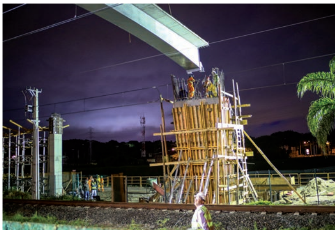
Bild 17 Nächliche Montage VFT-Träger über 2gleisige CPTM-Metrolinie mit Oberleitung. Blick Richtung Westen auf Widerlagerbastion am Rio Pinheiros. Links Stütze der parallel zum flusseitigen Radweg verlaufenden Rampe Nightly assembly of 2-tracked CPTM metro line with overhead lines. View in direction west on abutment at Rio Pinheiros. On the left support of the ramp running parallel to the bicycle lane at the side of the river
