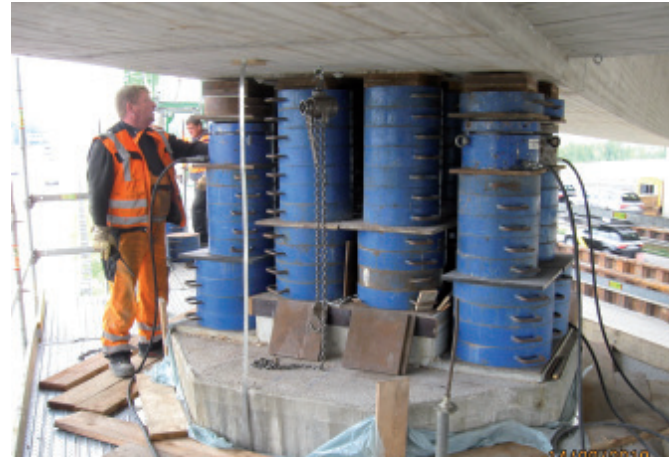
Bild 7. Abstapeln des 1. Bauabschnittes – Situation in der Achse 20 Fig. 7. Destecking of the first superstructure section – situation at axis 20
