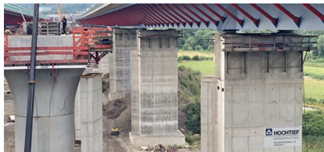
Bild 8 Behelfspfeiler vor Montage des Vershubträgers Temporary pillar before mounting the shifting girder
