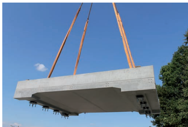
Bild 7 Einheben des Überbau-Fertigteils mithilfe eines Autokrans Lifting of the prefabricated superstructure using a mobile crane
