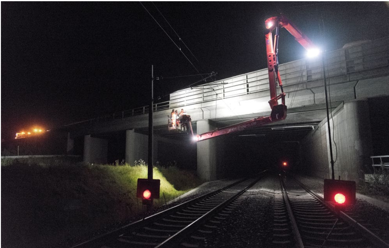
BW56 AUF DER A9 ÜBER DIE ST2232 UND DIE DB-STRECKE MÜNCHEN – TREUCHTLINGEN
